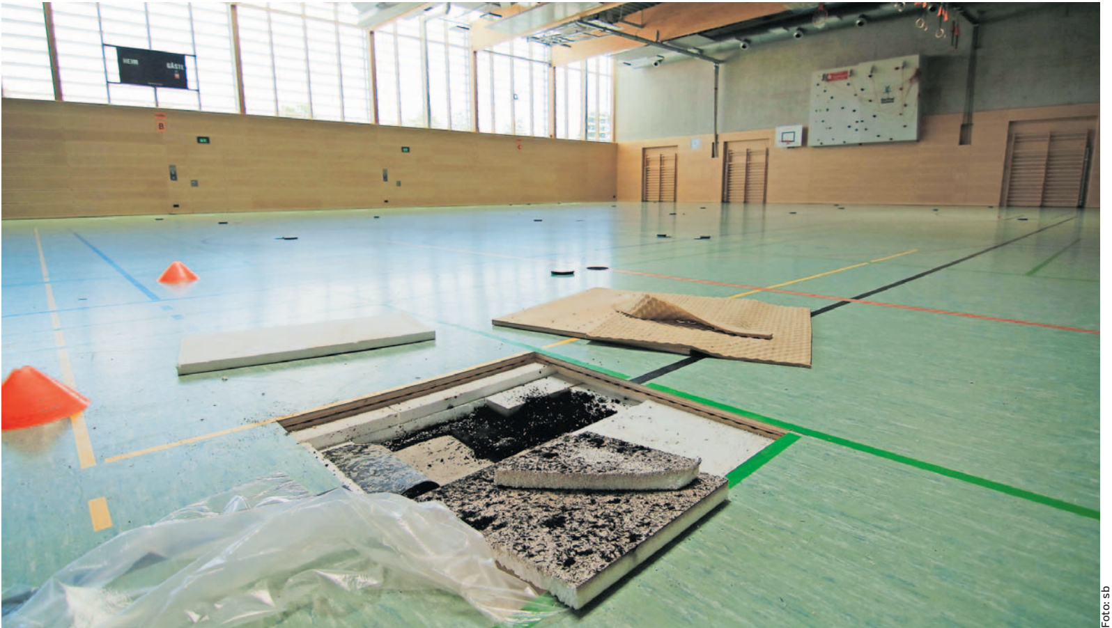
Die Burgberheimer Sporthalle kann wegen eines Wasserschadens mindestens bis zum Schuljahresende nicht mehr benutzt werden.
